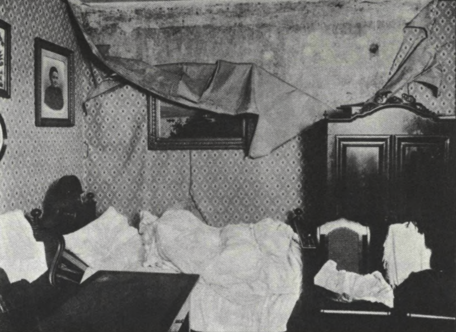
1917: Berlijn-Noord, Tegelerstraat 3, linker zijvleugel, 4 trappen. De aan haar ogen lijdende vrouw bewoont kamer en keuken. Aan de muren verschijnt schimmel, het behang heeft door vocht losgelaten (Asmus, 273).
